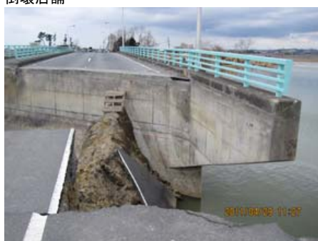
橋が落ちて寸断された道路
